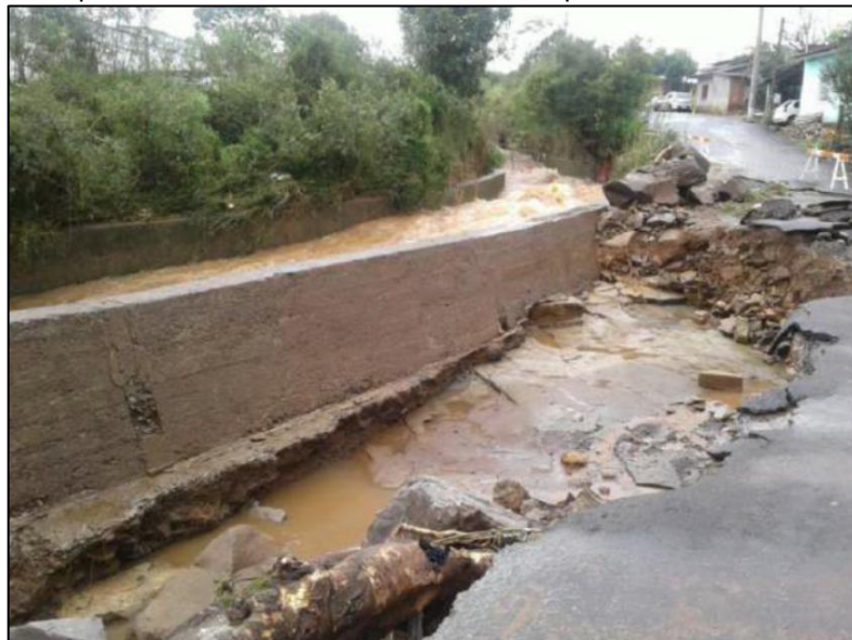
Figura 85 – Trecho da contenção do Arroio Barracão que rompeu devido a força das águas, promovendo danos a estrada, período de maio de 2017
