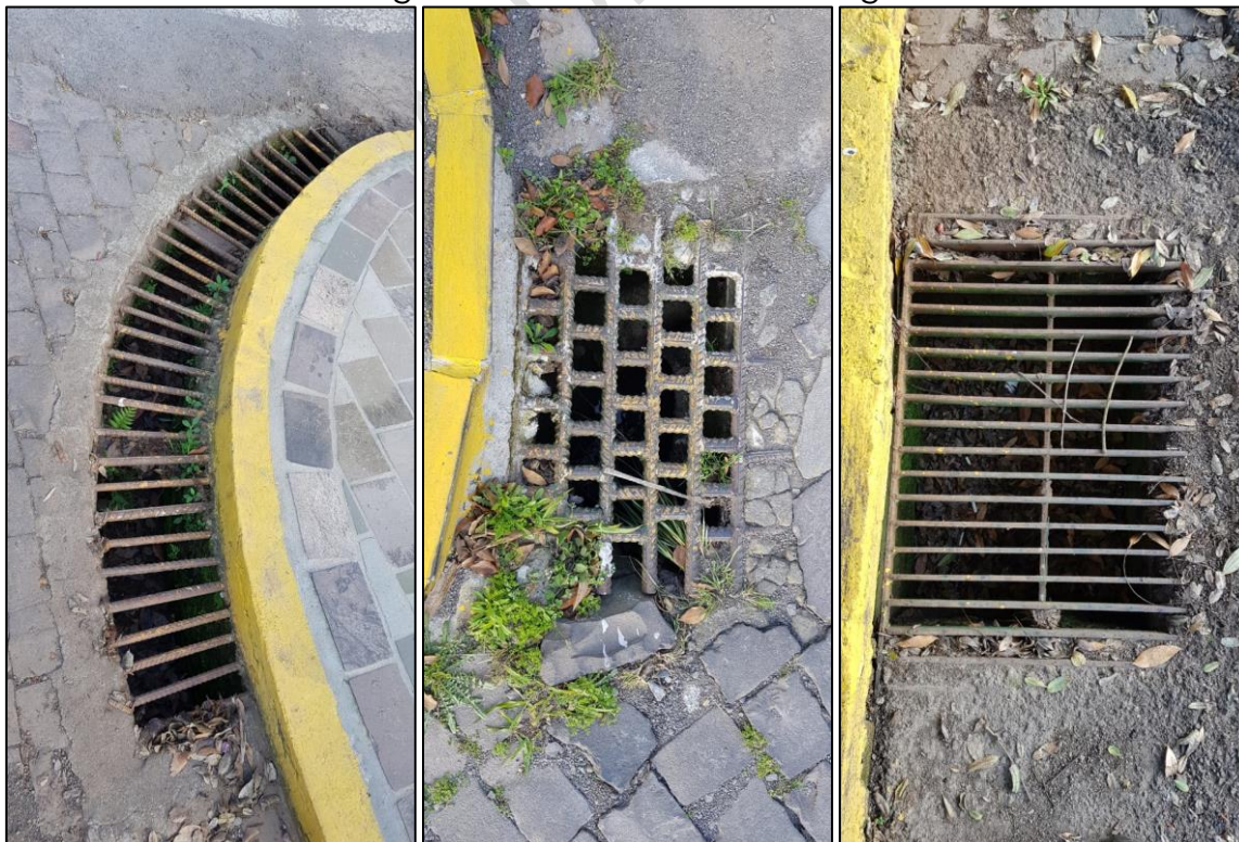
Figura 80 - Bocas de lobo com grade
