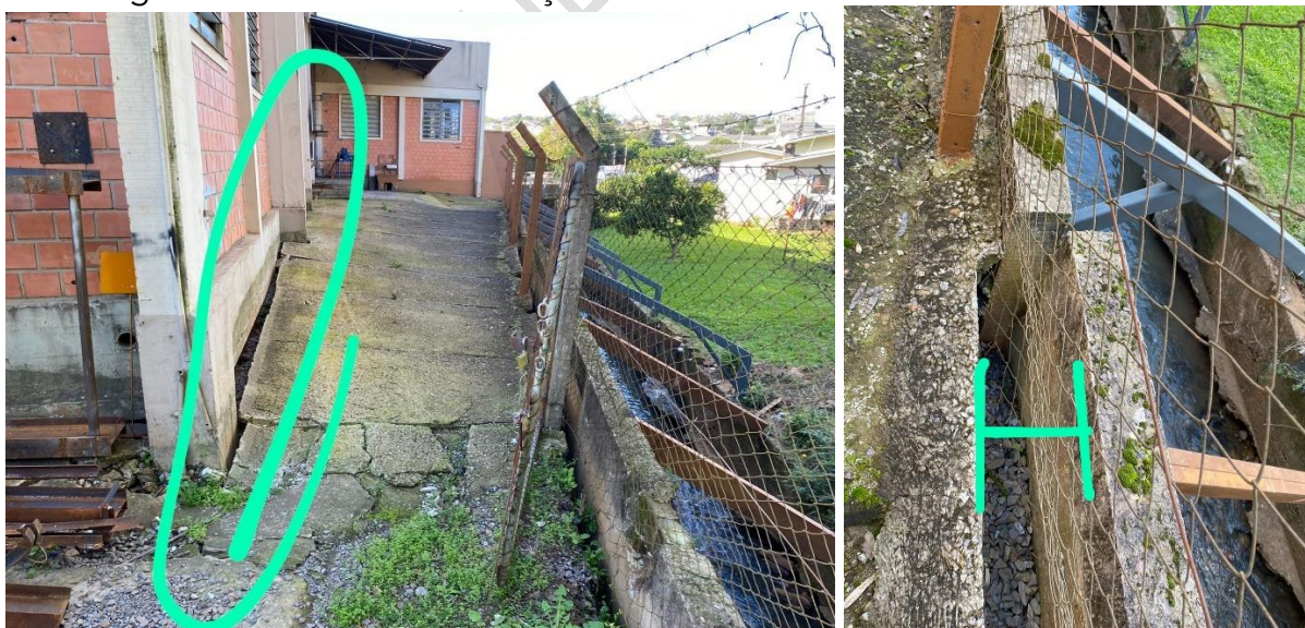
Figura 86 – Muro de contenção cedendo em trecho do Arroio Barracão
